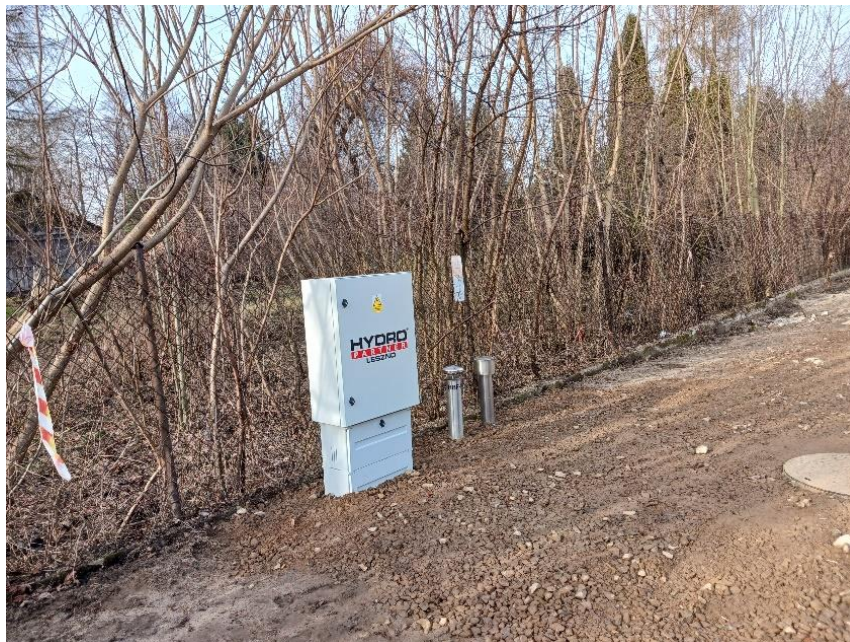
najazdowa sieciowa przepompownia ścieków w Nowodworze
