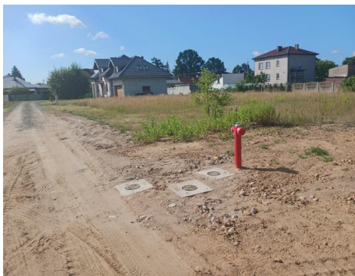
Hydrant na sieci wodociągowej ul. Wspólna w Siennicy
