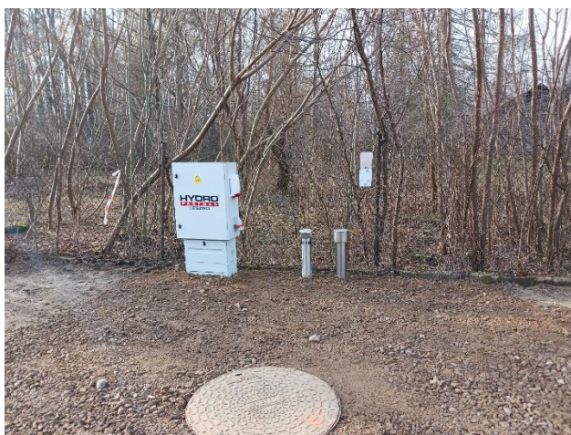
Sieciowa przepompownia ścieków w Nowodworze
