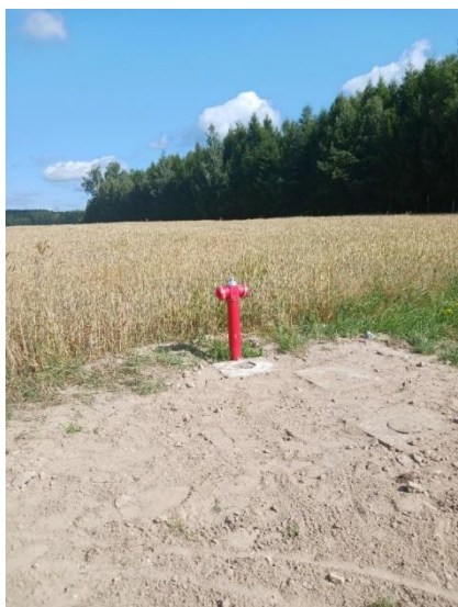
Hydrant na sieci wodociągowej ul. Góralska w Siennicy
