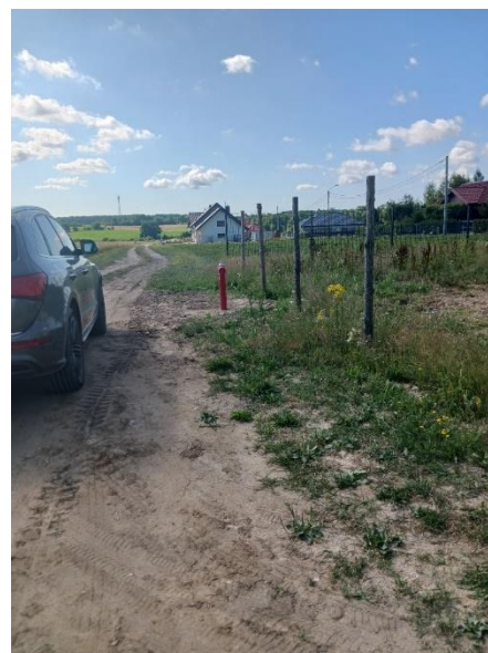
Hydrant na sieci wodociągowej ul. 8 Maja w Siennicy
